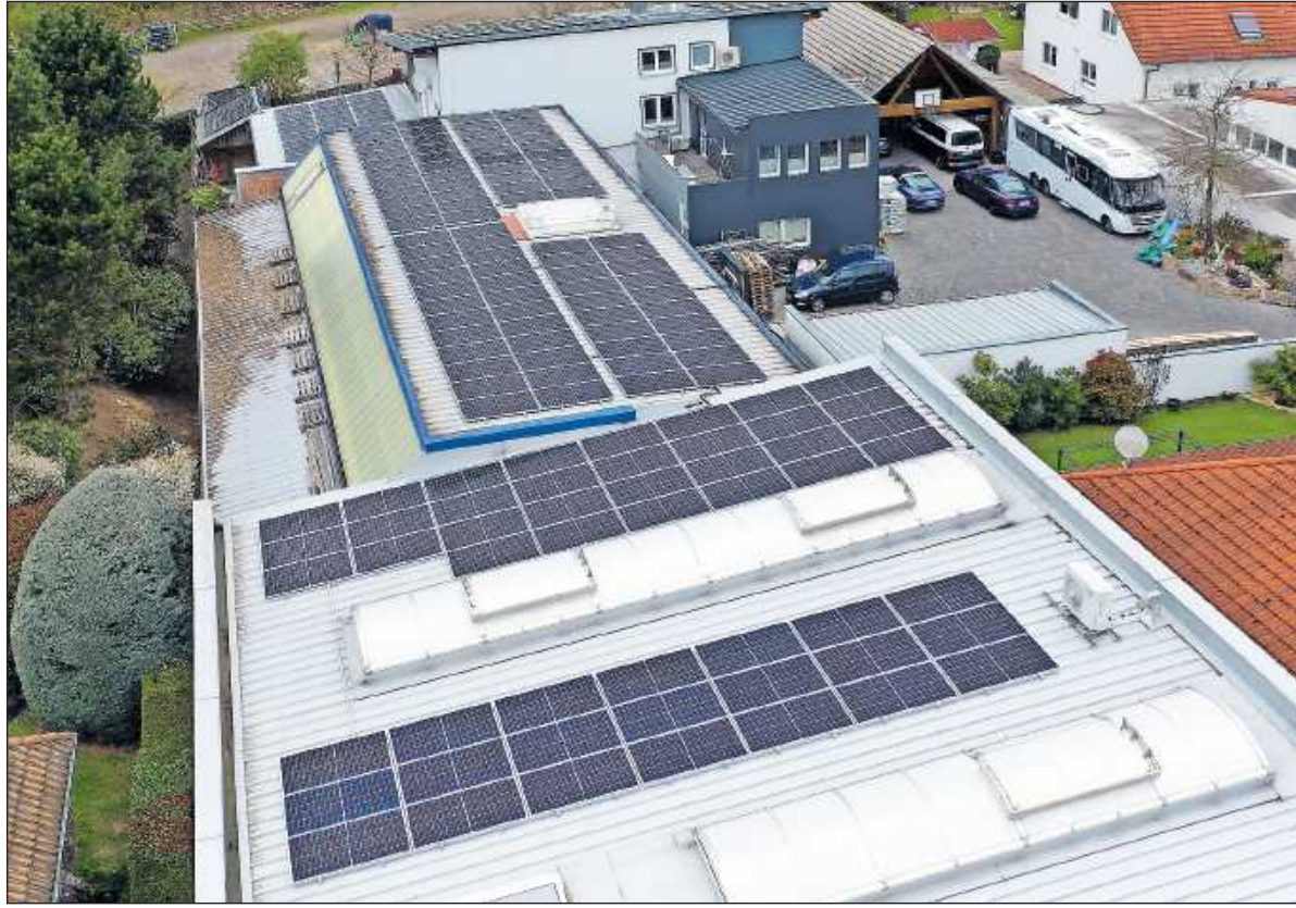
Die großen Dachflächen der Produktionshalle haben sich für Photovoltaik geradezu angeboten.
